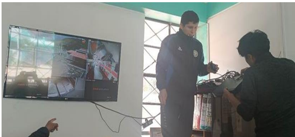
Figura 23 verificación de conexión
