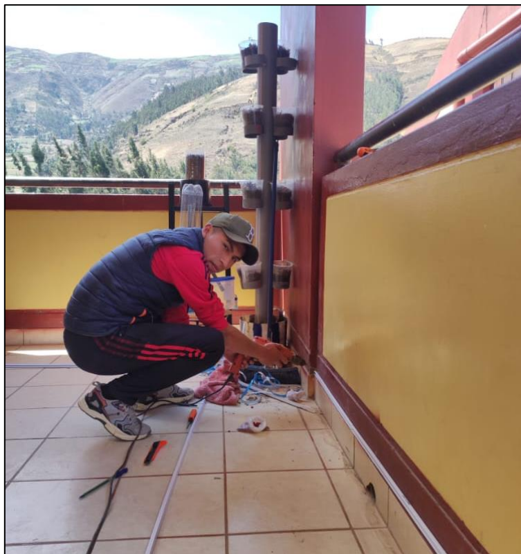
Figura 15: Tendido de canaletas por donde va a ar el cableado
