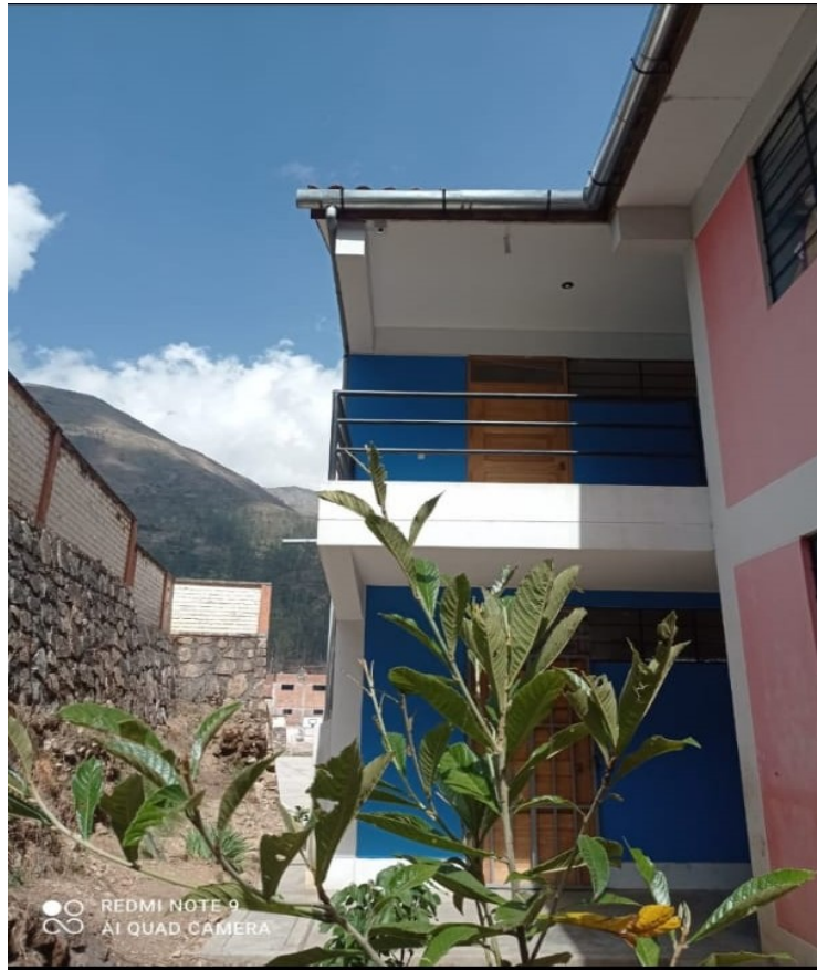
Figura 16: vista general de la cámara 2, instalada.
